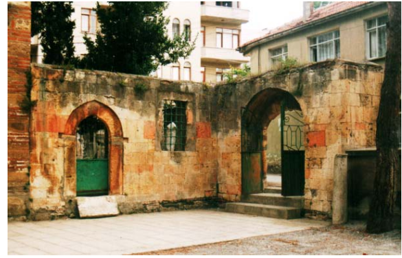
104. Bafra - Ulu Camii, avlu kapısı ve hazire girişi (2002 restorasyon öncesi).
