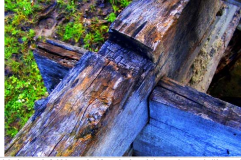
664. Asarcık / Kılavuzlu Köyü'nde yıkılmış ahşap değirmenin ahşap duvar perdelerinde kurtboğazi geçme detayı .
