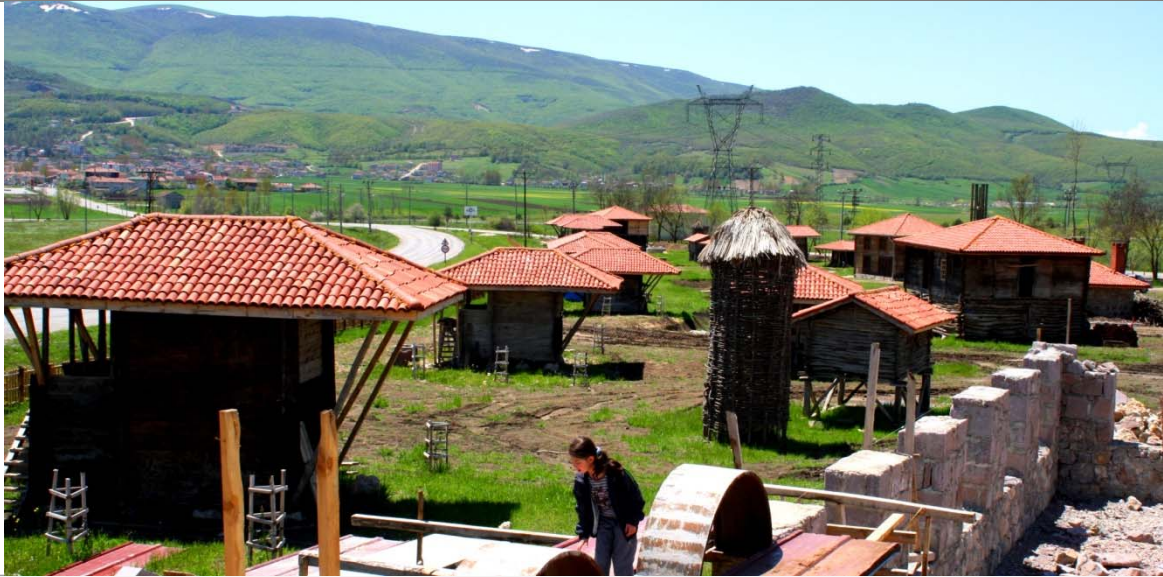
667. Ladik Ambar Köy Projesi kapsamında çevre köy ve ilçelerden toplanıp yeniden kurulan çoğu ahşap çeşitli kırsal yapılardan (2011).
