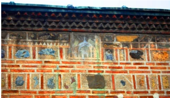
107. Bafra - Ulu Camii, kible duvarı saçak altı, detay (cami tasviri).
