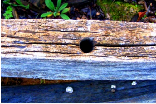
665. Asarcık / Kılavuzlu Köyü'nde yıkılmış ahşap değirmenin ahşap duvar perdelerinden birinde kavila deliği.
